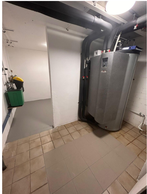
Heizraum mit Wärmepumpe
