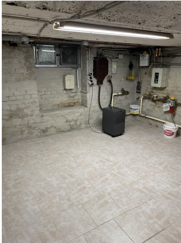
Keller mit Hausanschlüssen
