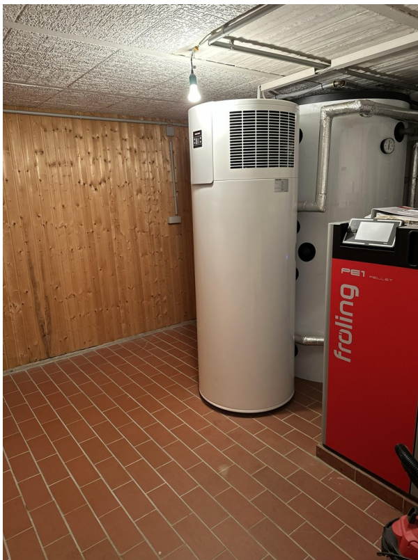
Heizkeller mit Stauraum
