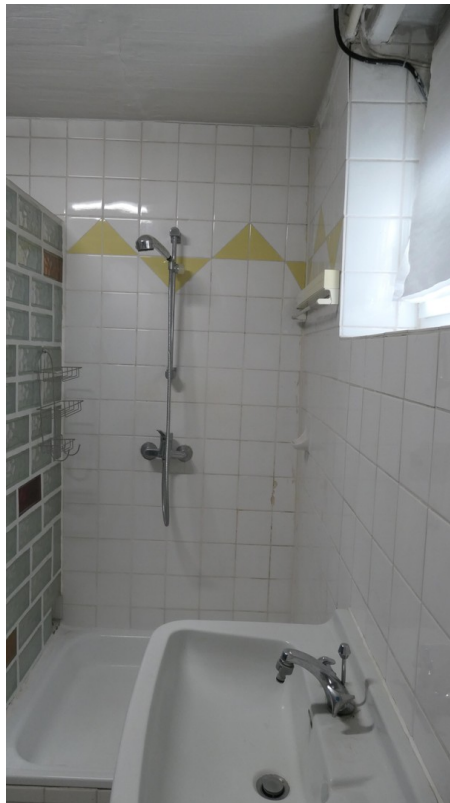
Dusche und Waschbecken im KG
