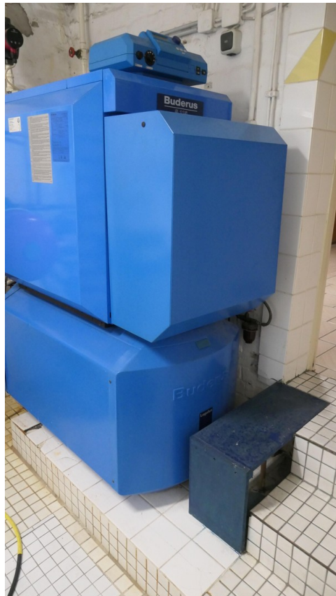
Heizkessel Buderus von 1999
