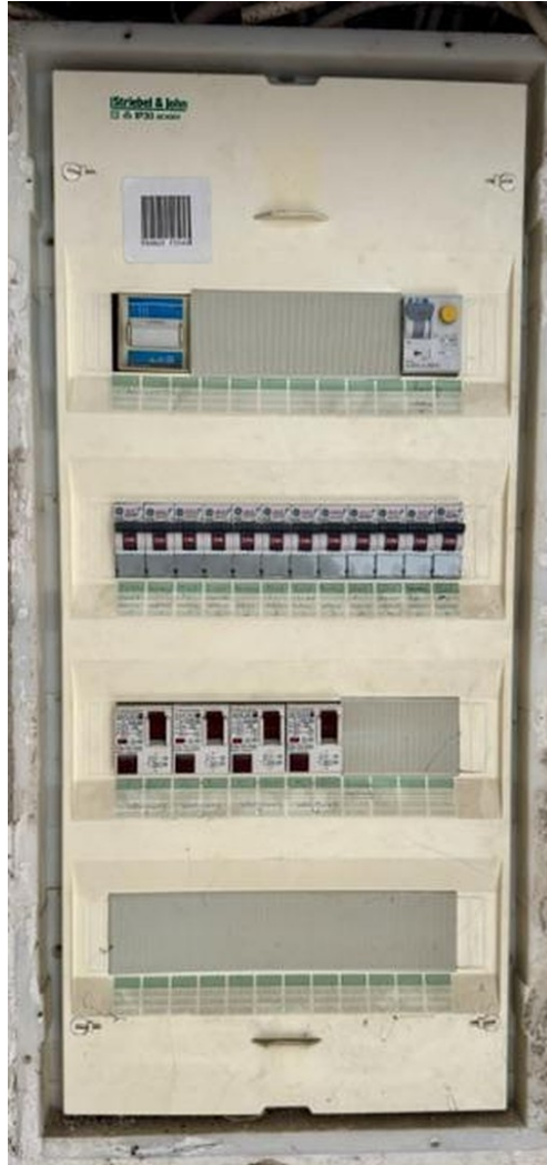
Elektrik Flur DG
