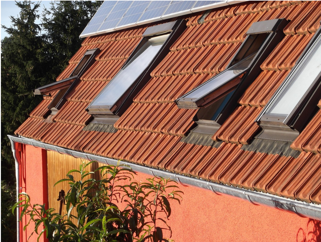
Dach mit PV Hinterhaus
