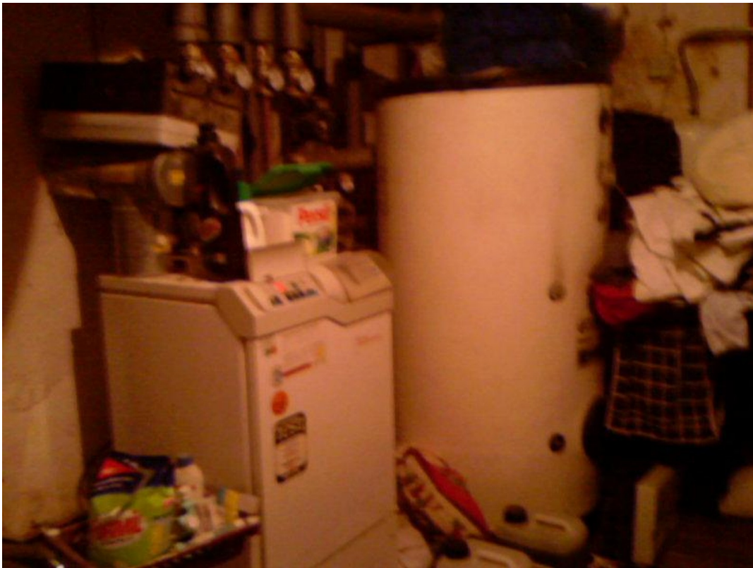
Heizung mit Warmwasser
