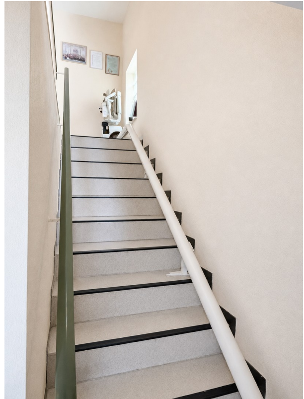
Treppenhaus mit Treppenlift
