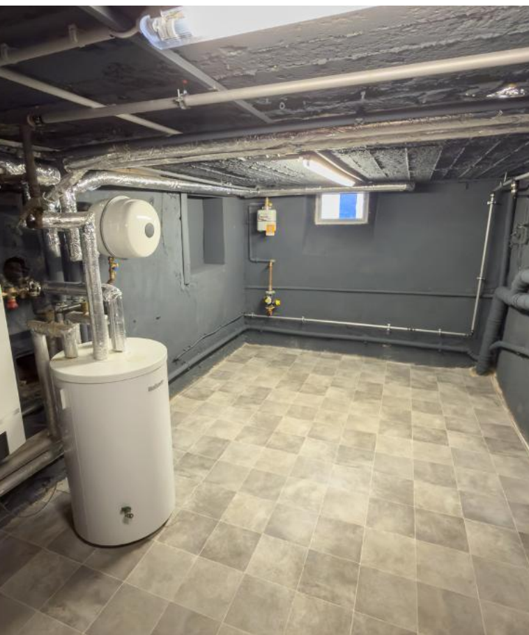
KELLER-HEIZUNGSRAUM DES HAUSES
