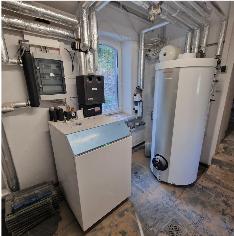
Heizung und Warmwasser
