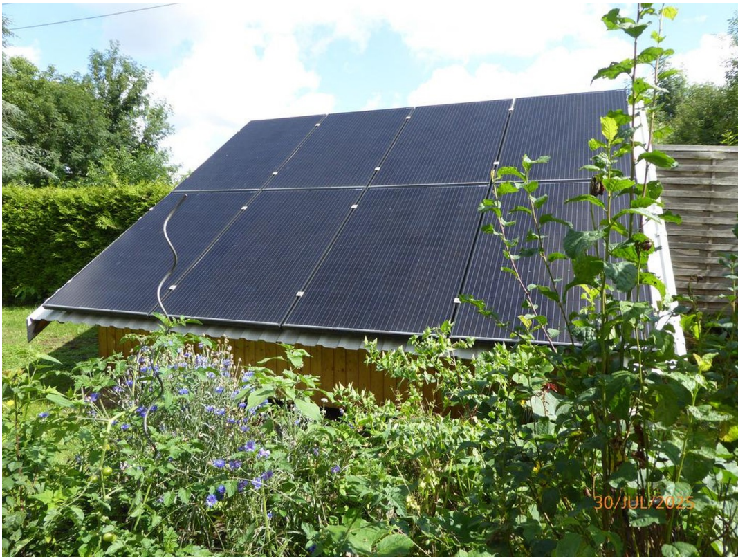
PV Anlage Geräteschuppen
