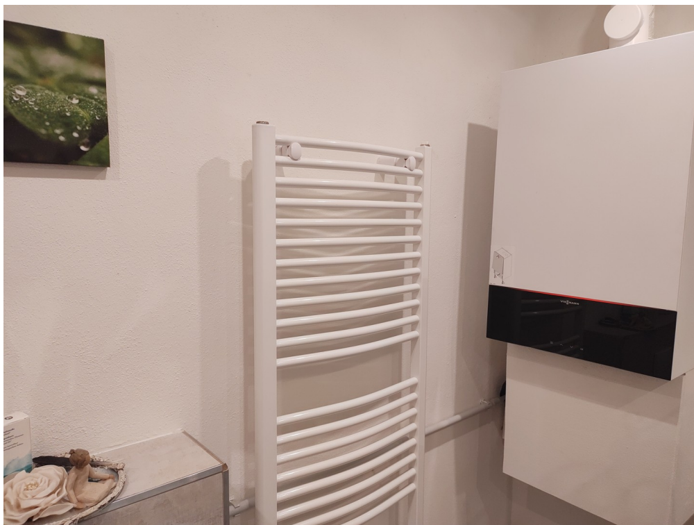
Badezimmer mit Heiztherme
