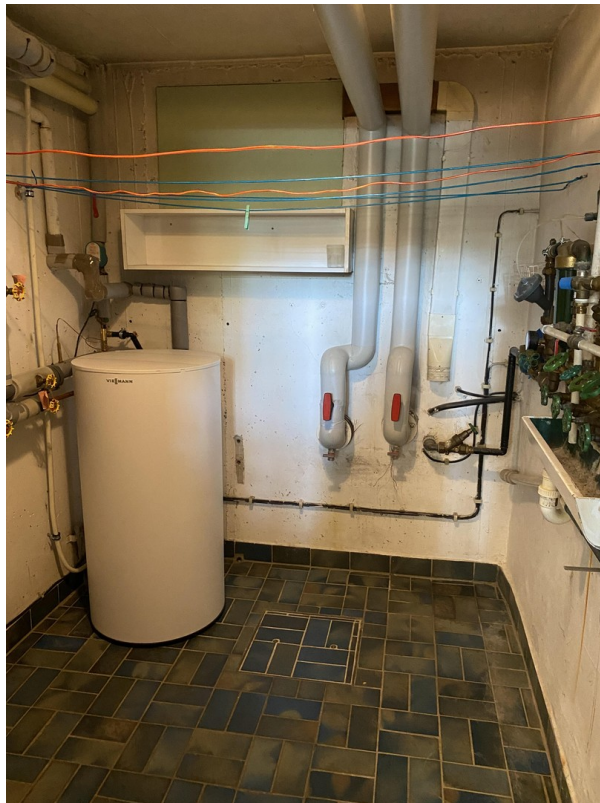
Heizraum und Waschküche
