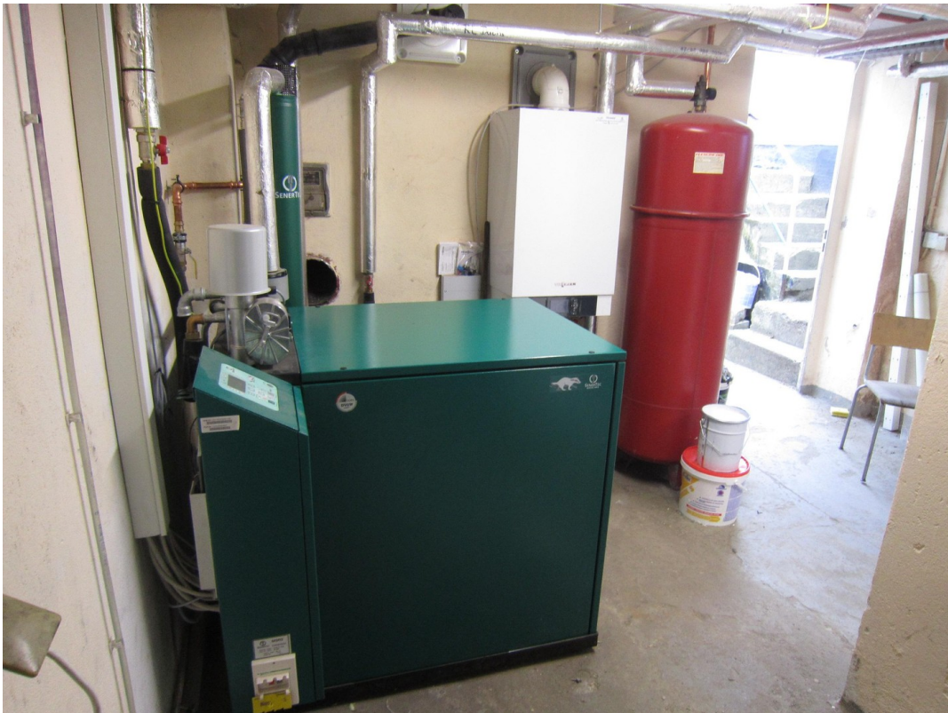
BHKW als Heizung
