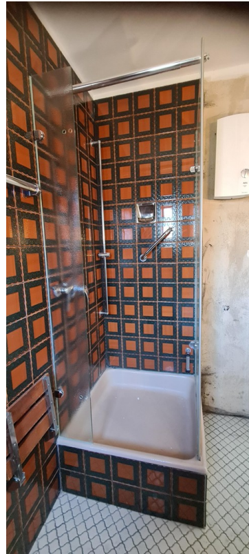
Dusche in Badezimmer 2
