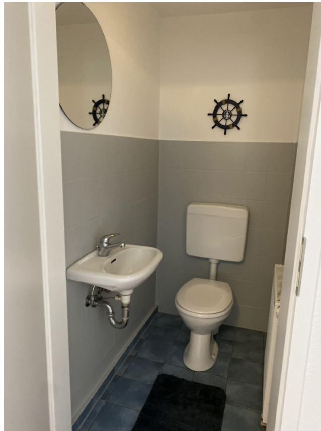
Haus 28: WC 1. OG
