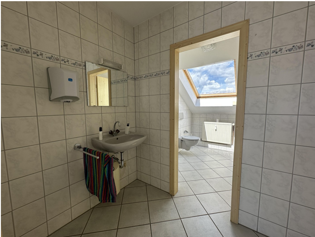
WC-Anlage Büro OG
