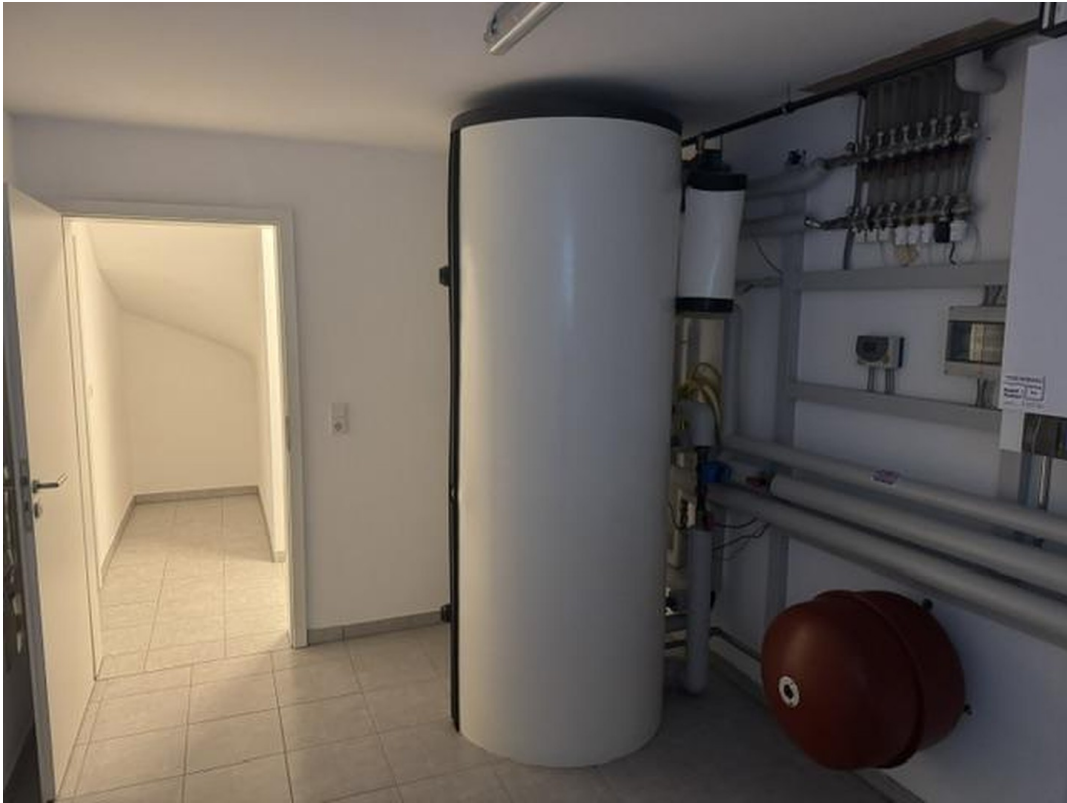
Keller mit Heizung
