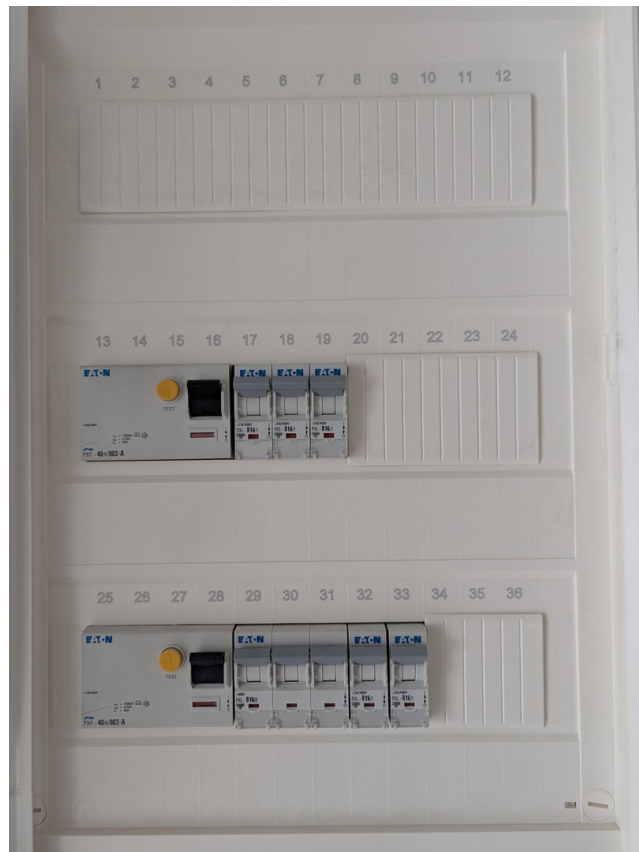
neue el. Unterverteilung
