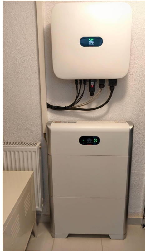
PV-Anlage mit Speicher 2023
