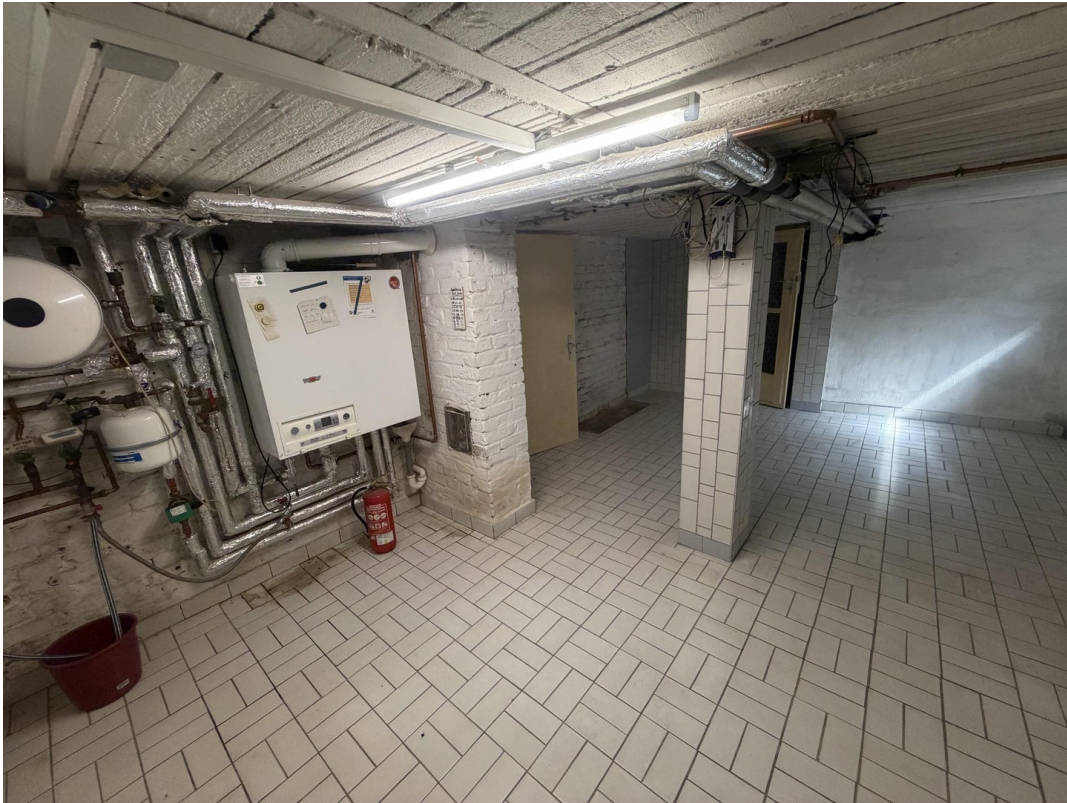
Keller mit Gasheizung
