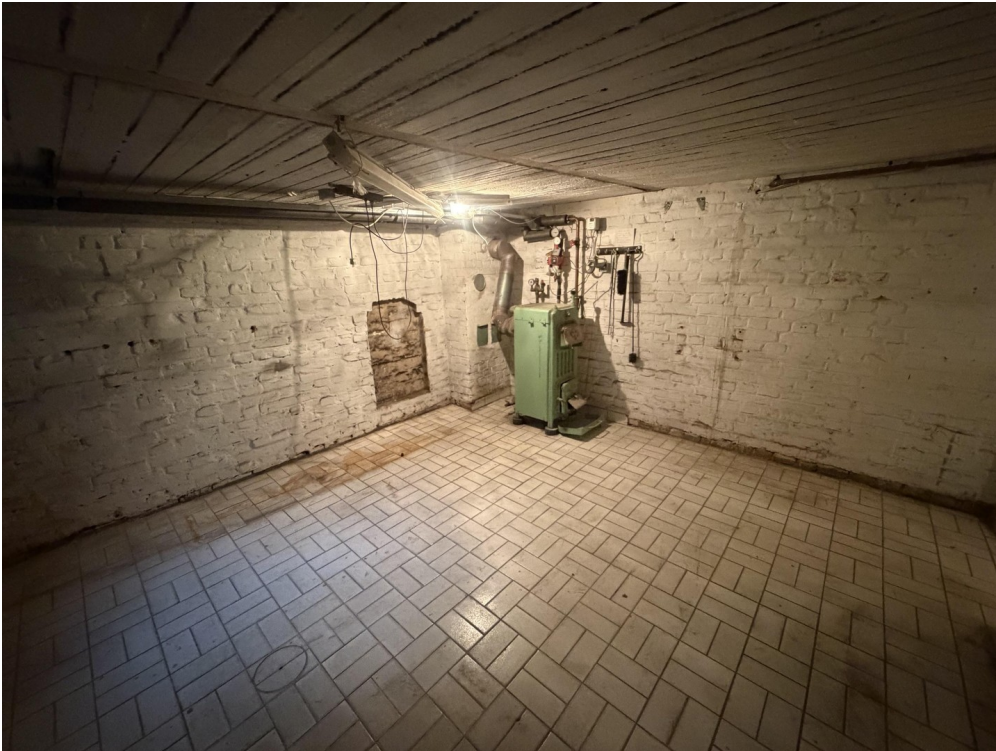
Keller mit Holzheizung
