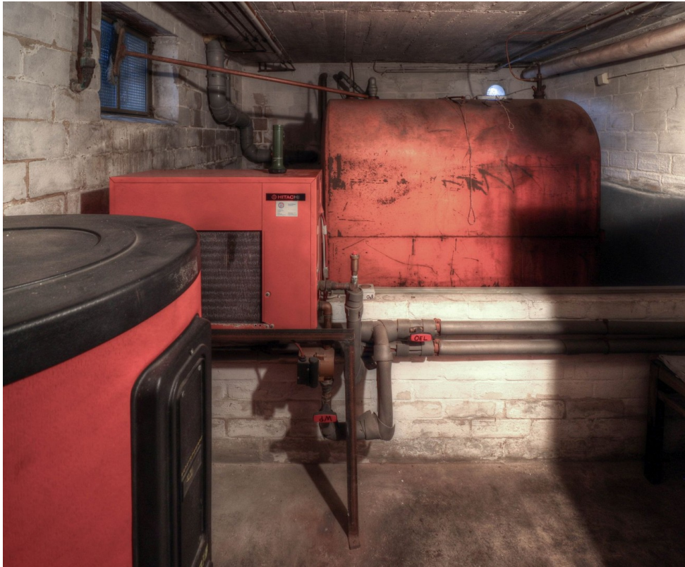
Heizung im Keller
