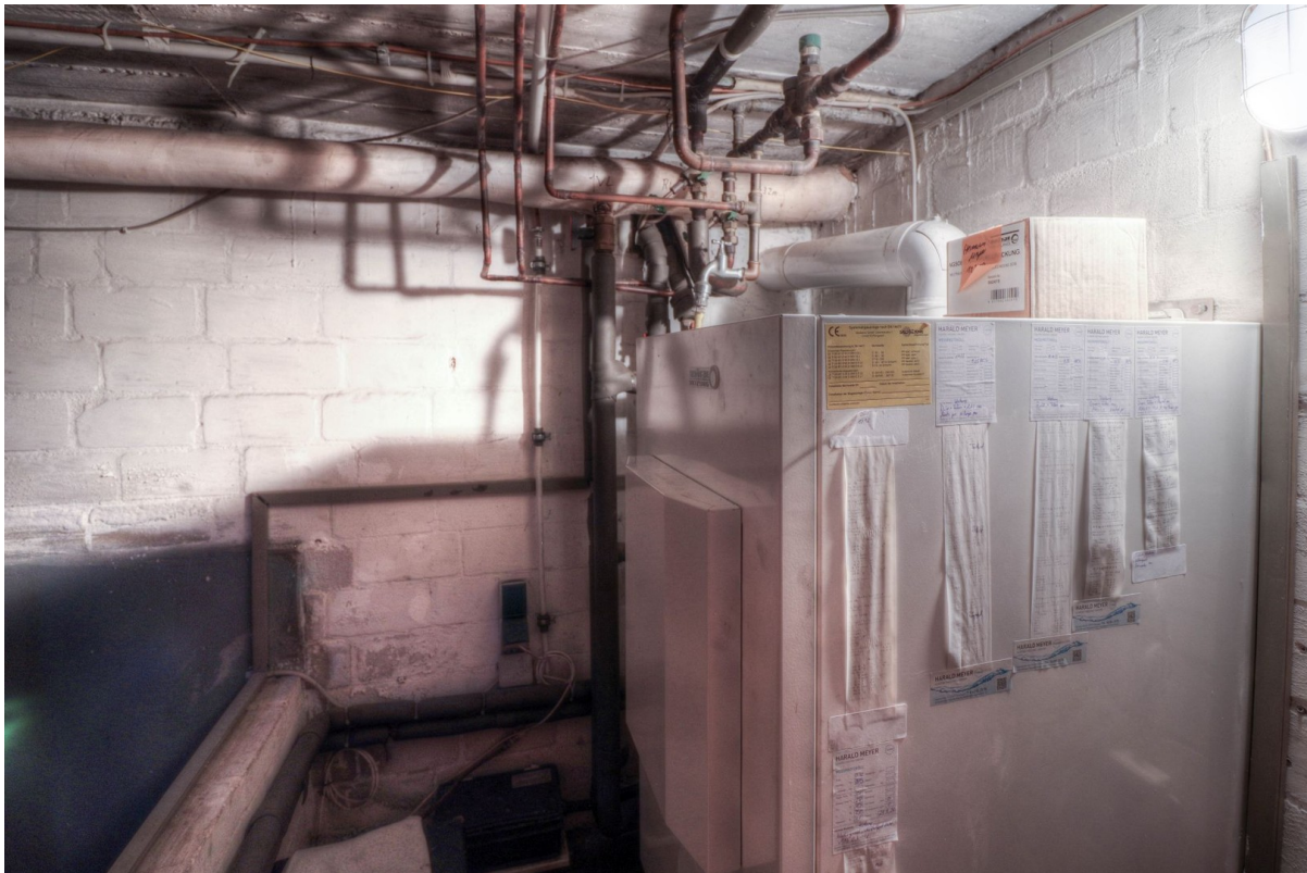
Heizung im Keller
