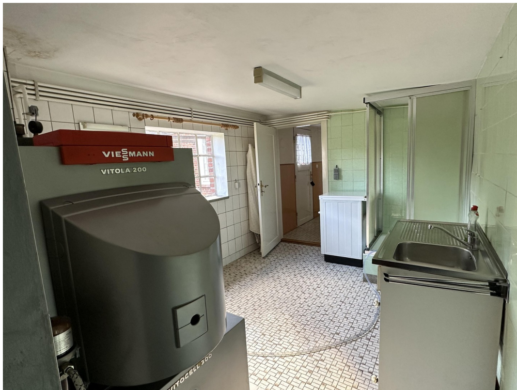
Heizungsraum mit Dusche
