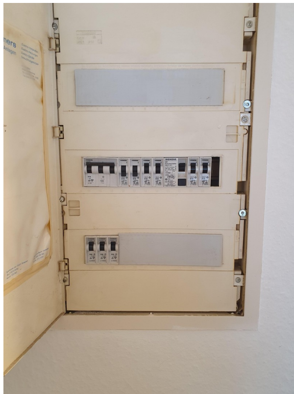
Sicherungskasten in der ETW
