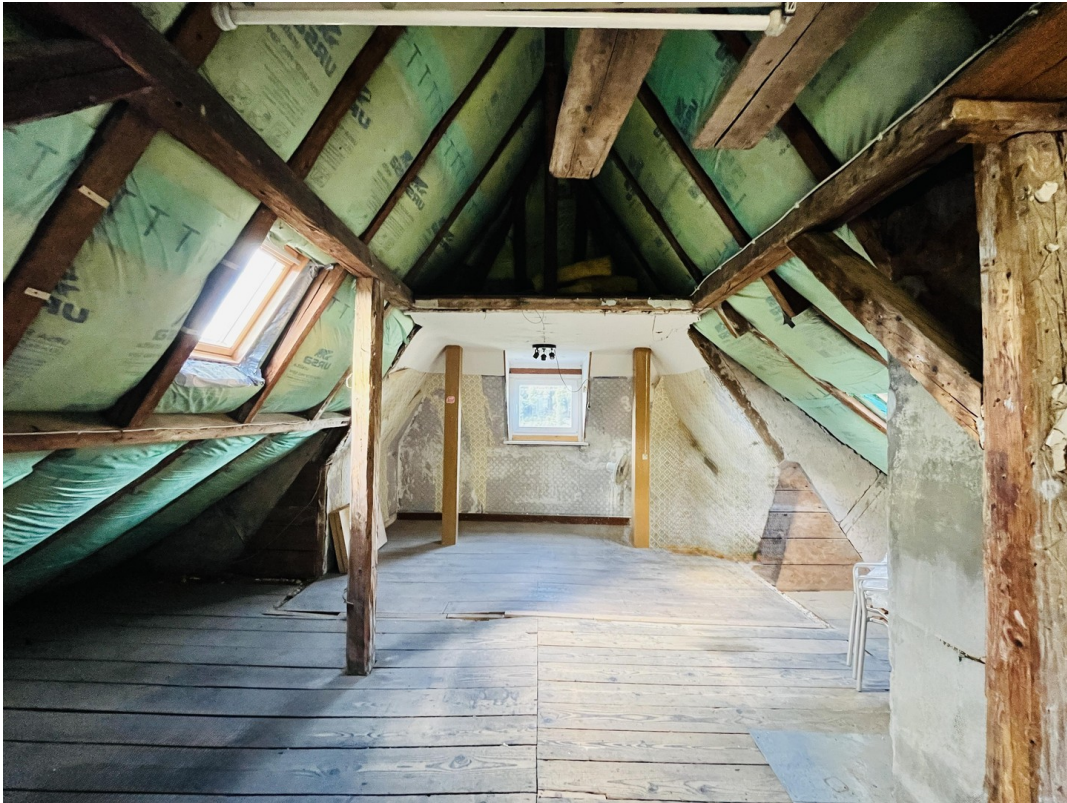
DG nicht ausgebaut
