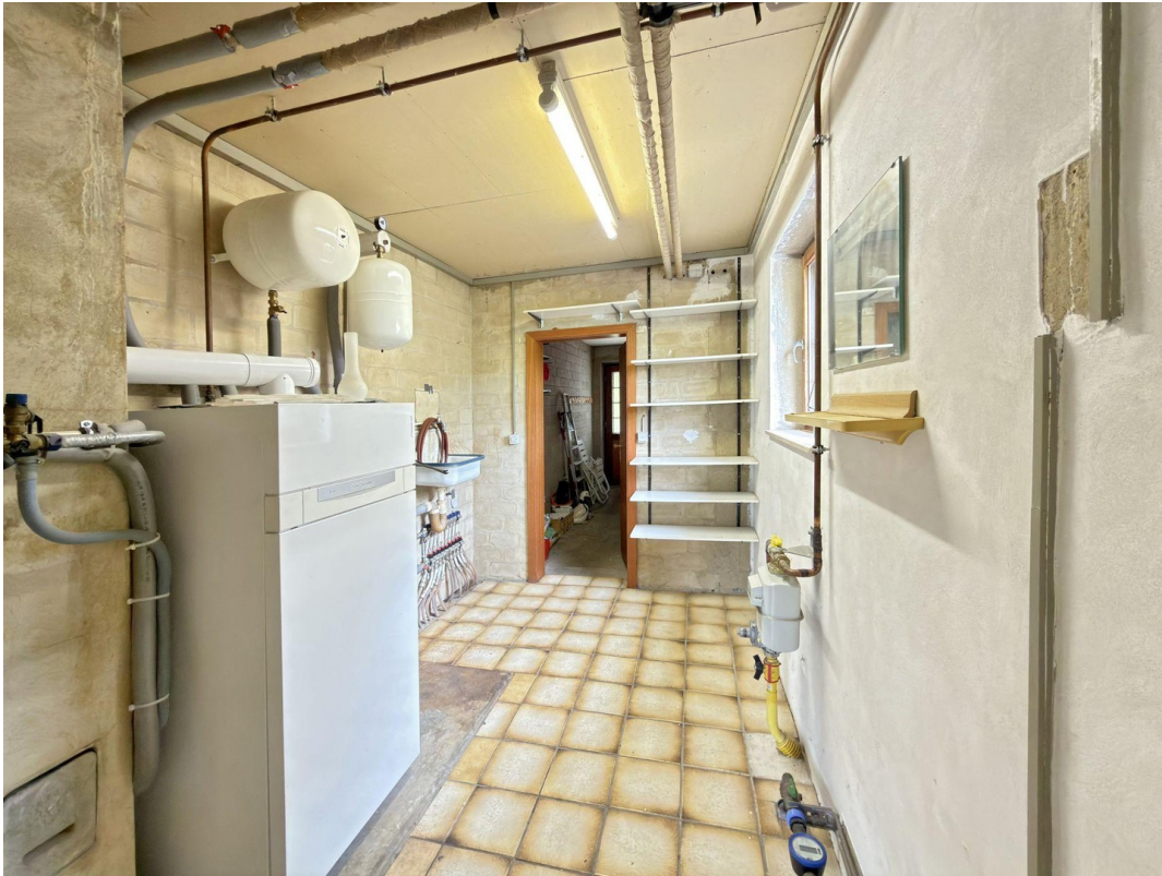
Heizungsraum und Vorrat
