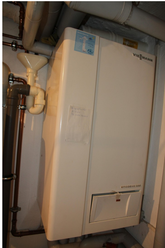
Heizung KG Gastherme
