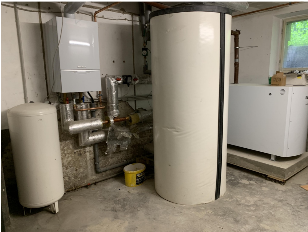
BHKW Vaillant Bild 1
