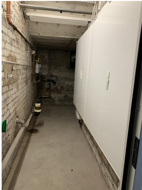
Stromkasten im Keller
