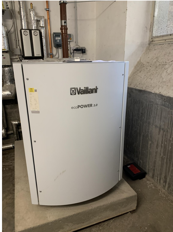
BHKW Vaillant Bild 2
