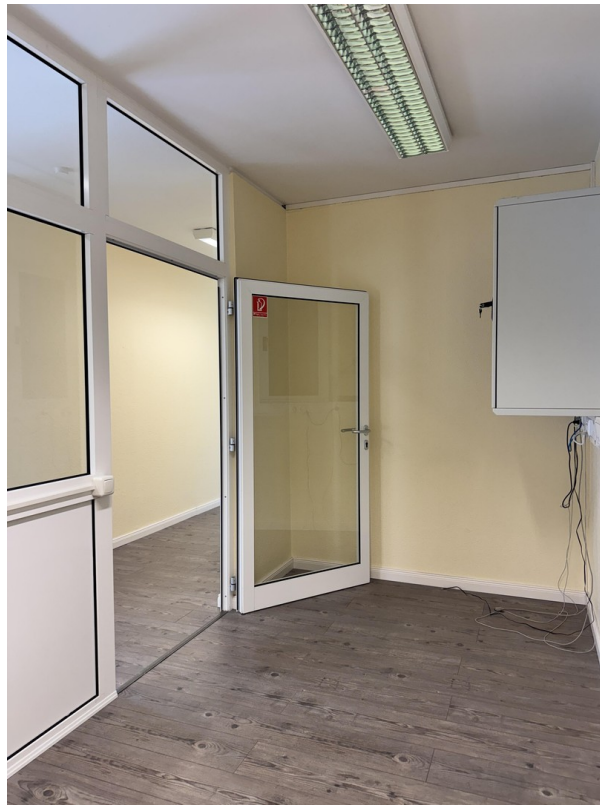
Geräteraum von innen
