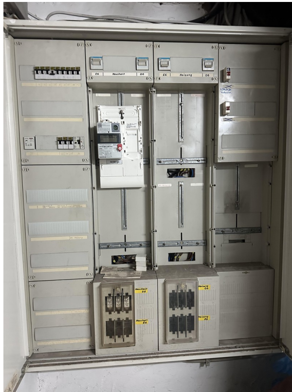
Elektro-Kasten im Keller
