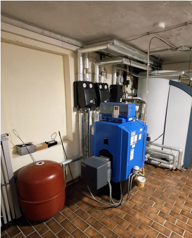
Heizungsanlage im Keller
