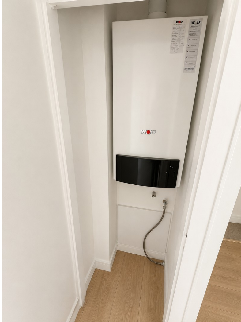
Abstellraum mit Therme
