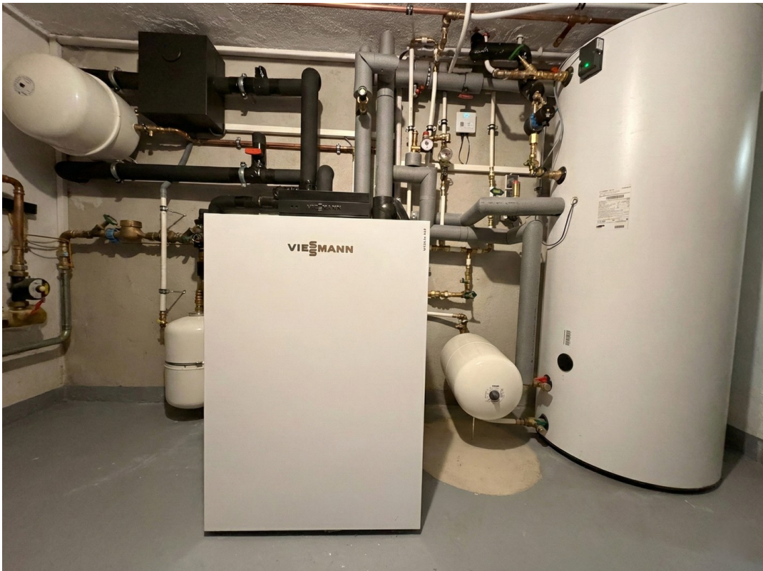
Geothermie Heizung aus 2024
