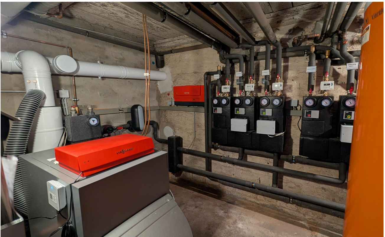
Neue Heizung (Bja. 2023)
