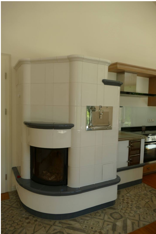
Grundofen und Anschluss Küche
