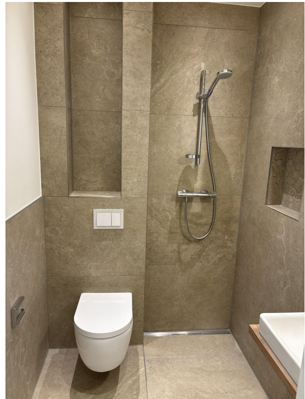
Gäste-WC (Glaswand fehlt)
