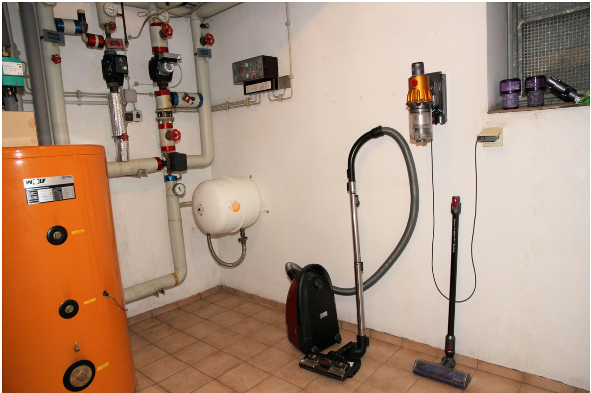
Heizungs- und Trockenraum
