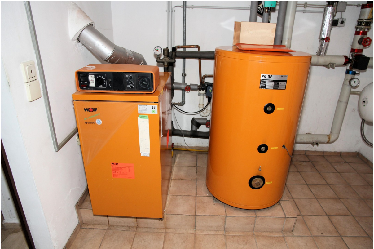
Heizung und Warmwasserspeicher
