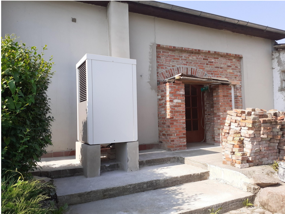
Eingang mit Wärmepumpe links
