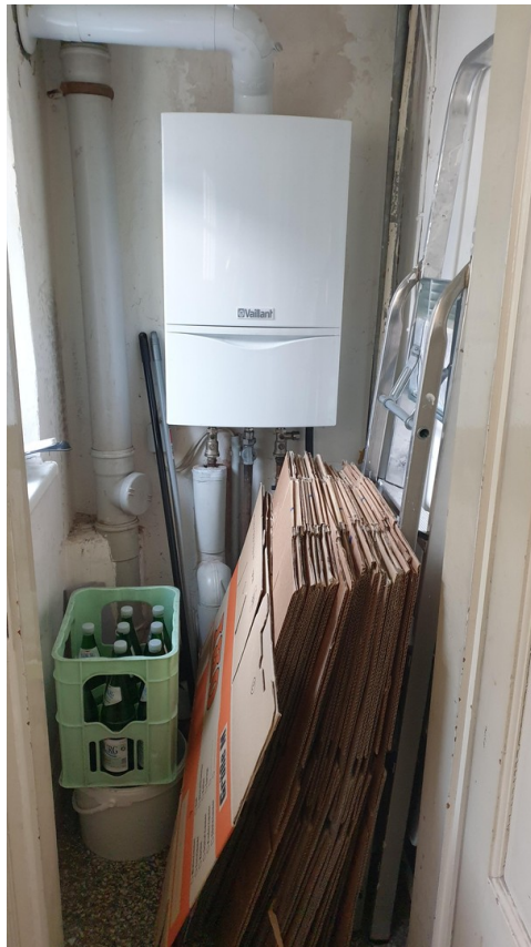
Abstellraum mit Therme
