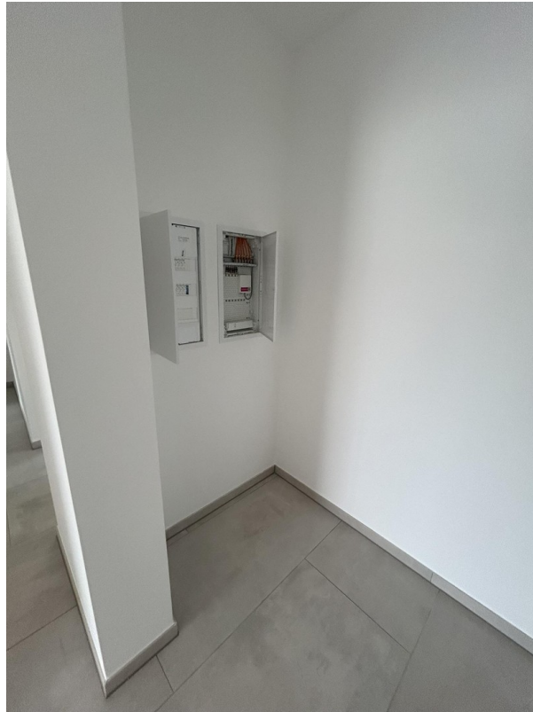
Unterverteilung und Glasfaser
