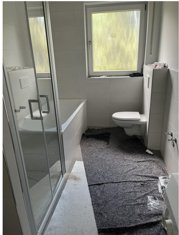
Bad mit Dusche und Wanne
