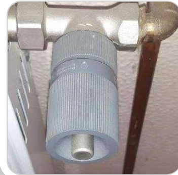
Heizkörperventil ohne Voreinstellung
