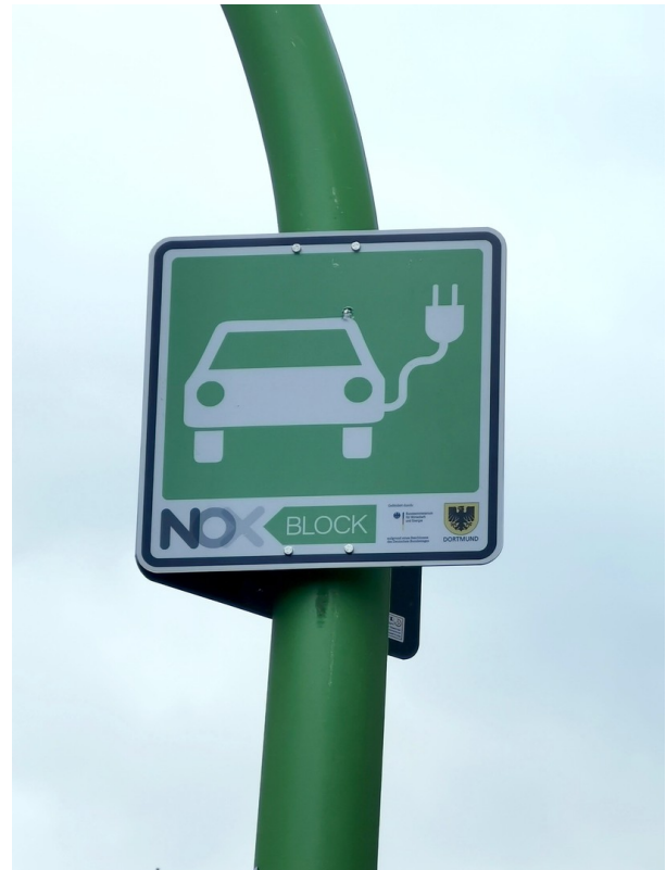
Laternen mit Ladestation 2
