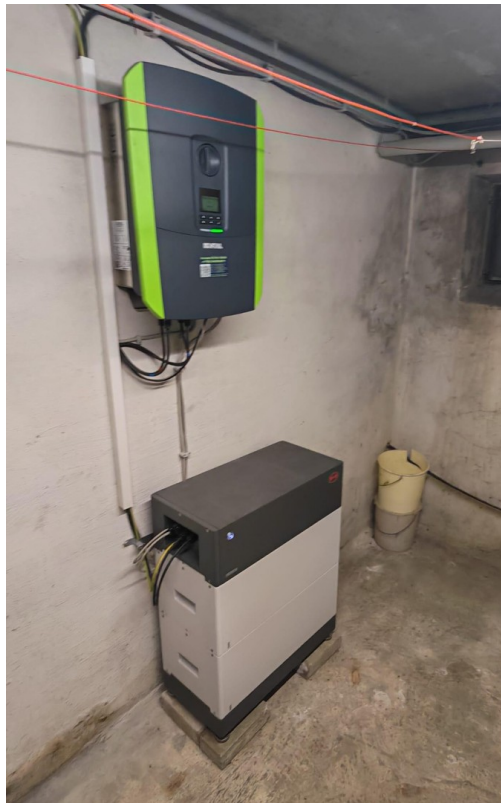
Kostal WR + Speicher
