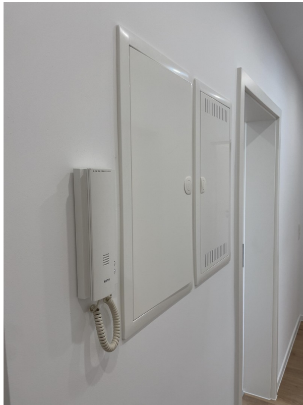
Unterverteilung und Netzwerk
