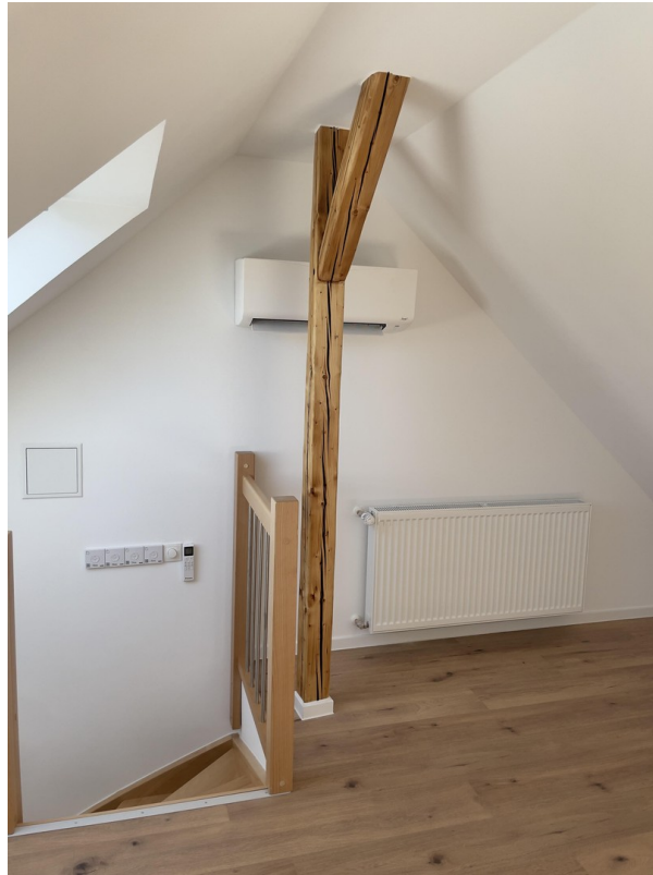
Klimaanlage UND Heizung
