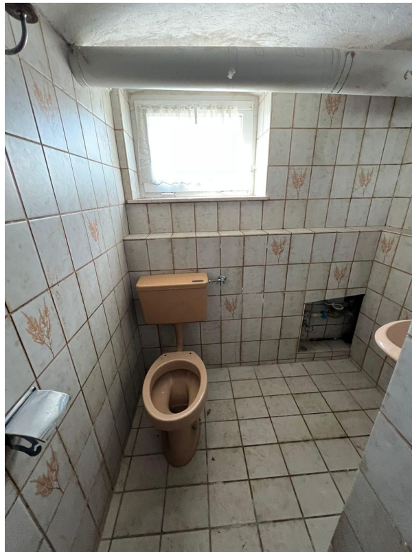
Duschbad im Keller
