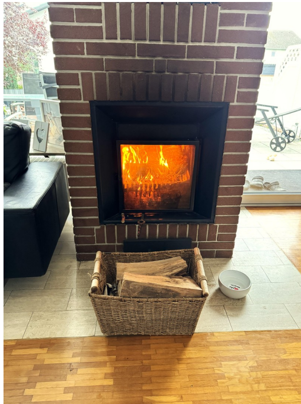
Kamin mit Wärmetauscher
