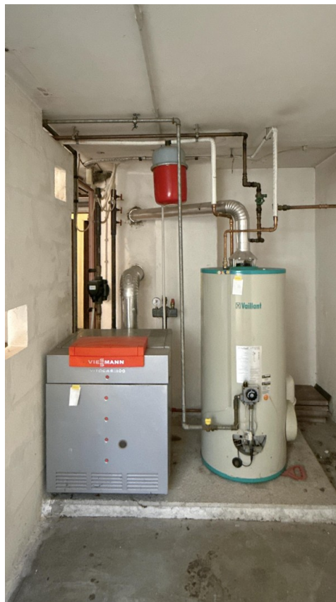
Heizung u. Warmwasserspeicher
