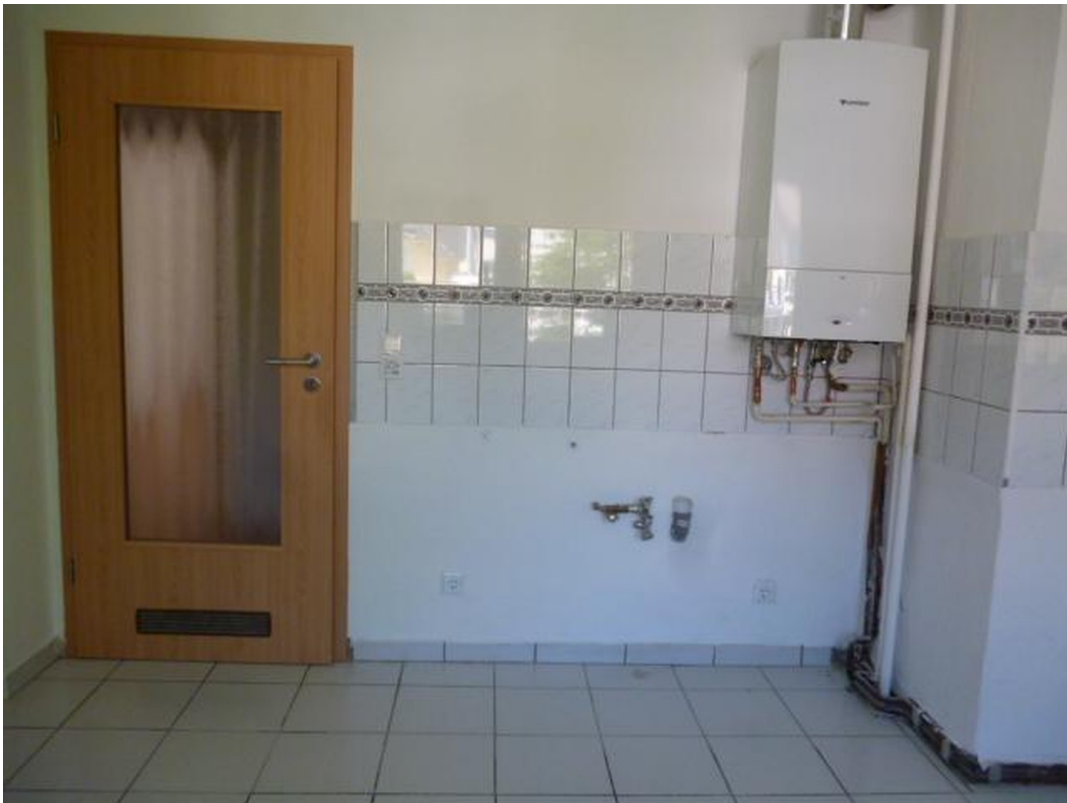
Küche mit Gas-Therme
