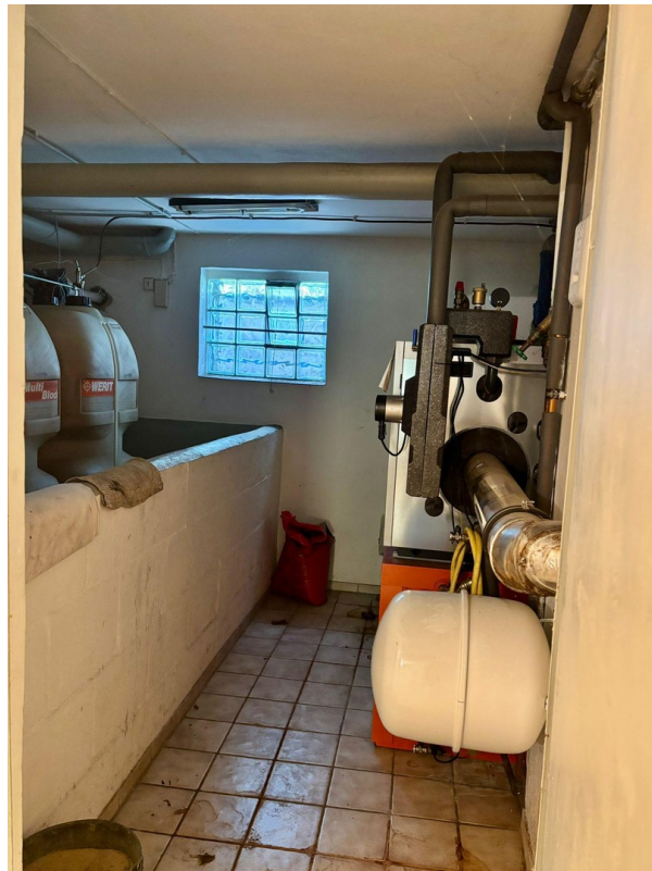
Heizungsraum mit Öl-Tanks
