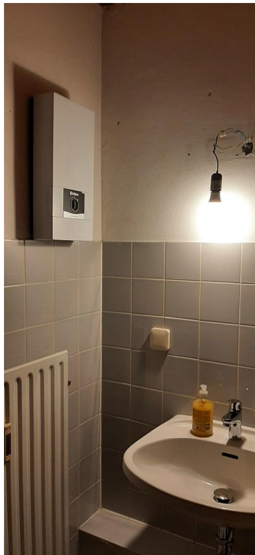
Bad, neuer Vaillant Durchlauferhitzer und Grohe Waschtischarmatur
